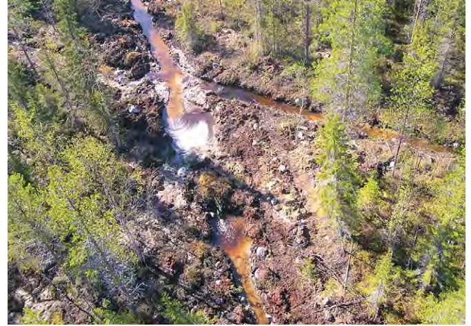
Kuva 80. Virtaamaa säätelevä putkipato ojituskohteella. JURI LAURILA.
