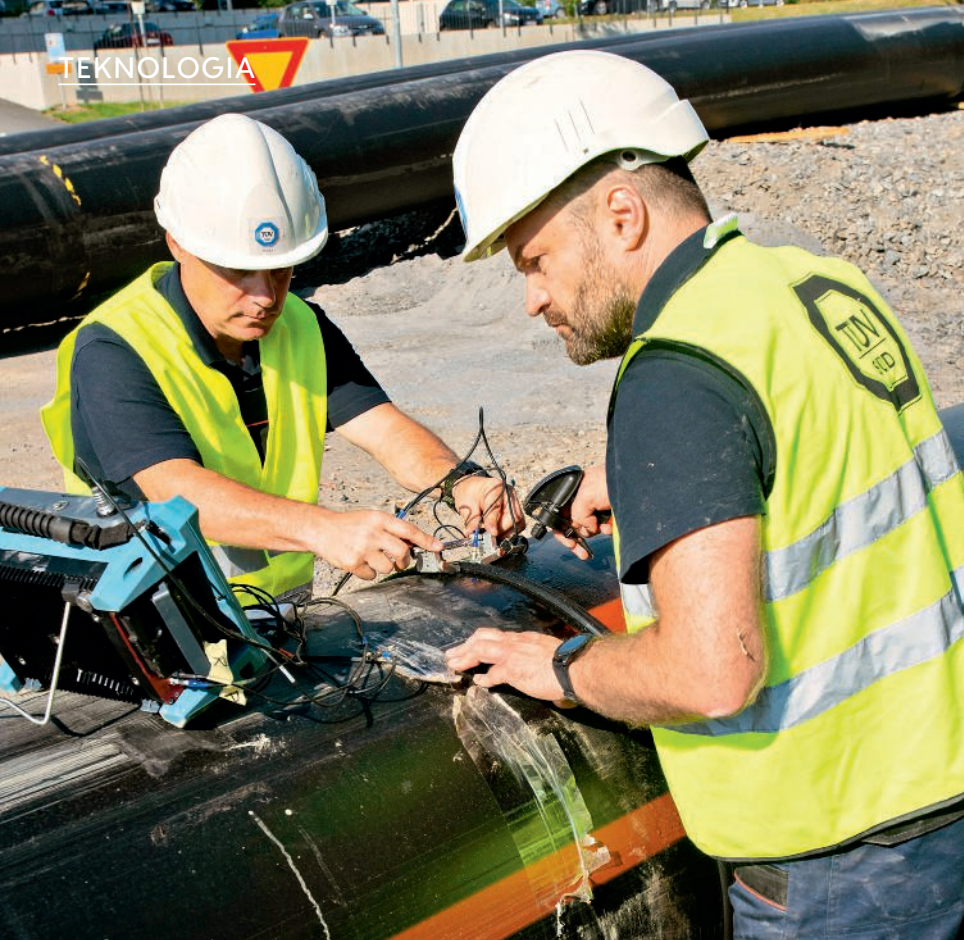
Georg Fischer AG:n kuvantajat Slawomir Czerwonka (oik.) ja Robert Wisniewski testasivat Pirkkalassa jätevesiputkiston hitsausseamojen pitävyyttä.
