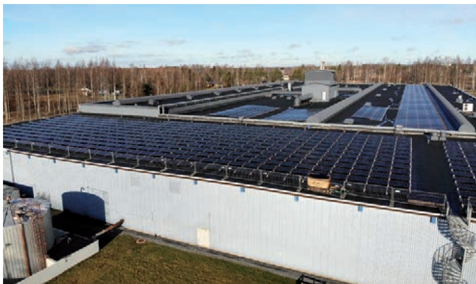
Kokemäen tehtaan katolle on asennettu kelluvana asennuksena SolarThor-aurinkopaneelleja, jotka on tehty kestäväksi ankariakin sääolosuhteita.
