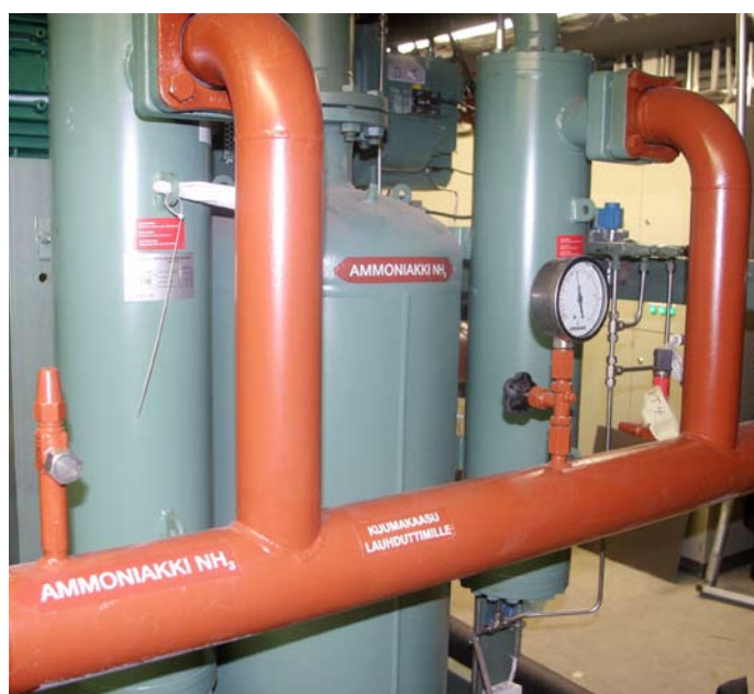
Reebok Areenan kylmäaine on ammoniakki. Jari Nyberg kertoo, että hiilidioksidiakin harkittiin, mutta koska siitä ei ole Suomesta jäähalleissa käyttökokemuksia, riskin vuoksi ajatuksesta luovuttiin.
