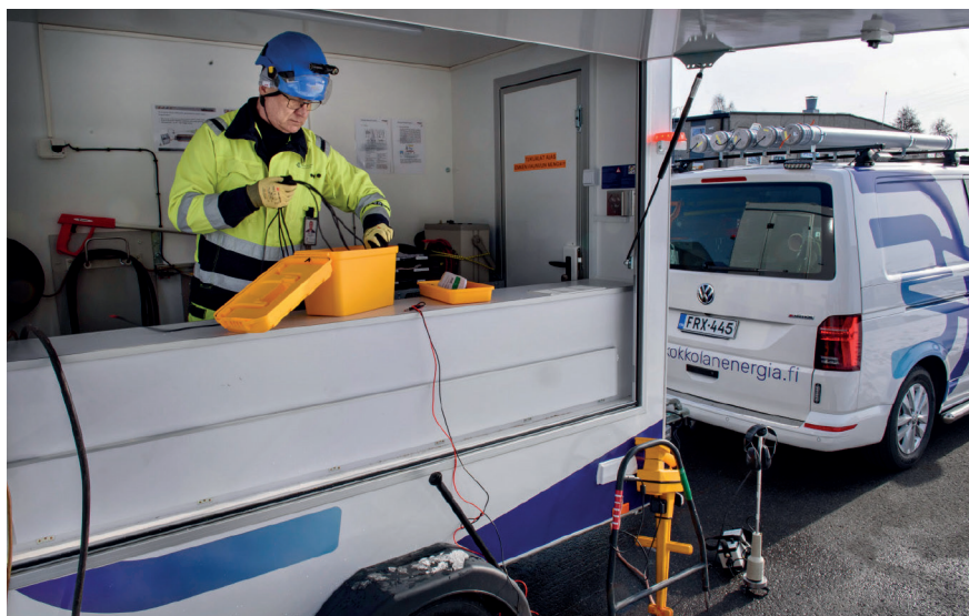
Elstationsmontör Risto Ekdahl ser till att utrustningsvagnen står redo för följande uppdrag.
