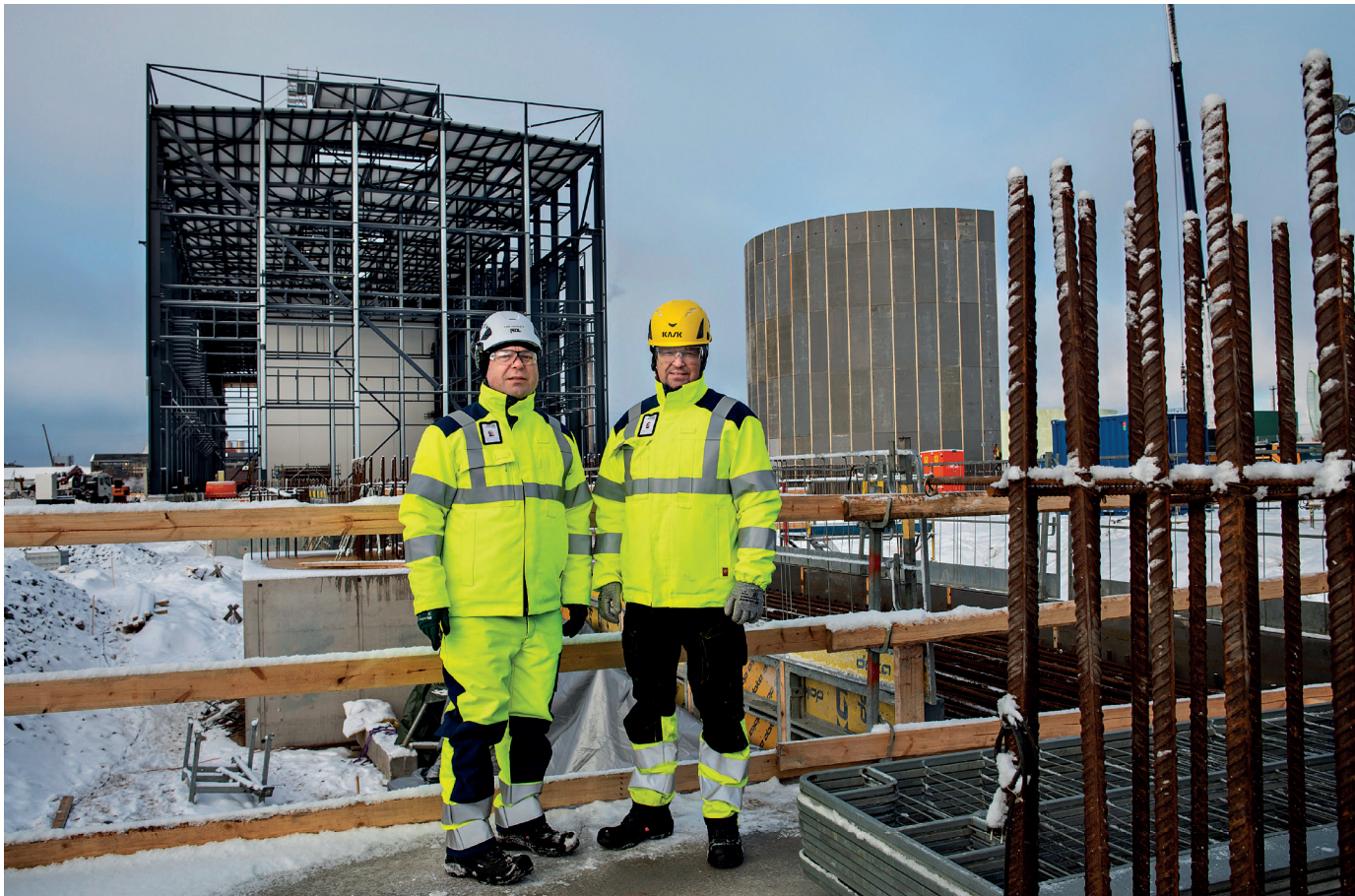
I Sibanye-Stillwaters Keliber-litiumprojekt används flytande naturgas vid värmebehandling av koncentrat i trumugnen. Vid grunden till den nya trumugnen står litiumraffinaderiets chef Sami Heikkinen (till vänster) och fabriks servicedirektör Manu Myllymäki.
