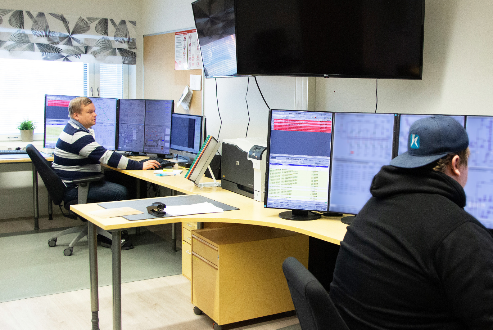
Käyttökeskuksessa sähköverkon tilannetta seurataan kaiken aikaa, ja tieto mahdollisista häiriöistä saadaan välittömästi.
