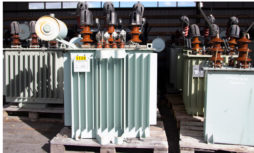
Muuntajat ovat pitkäikäisiä, kun niiden kunnosta pidetään huolta. Jopa 1980-luvulla valmistetut muuntajat palvelevat edelleen.
