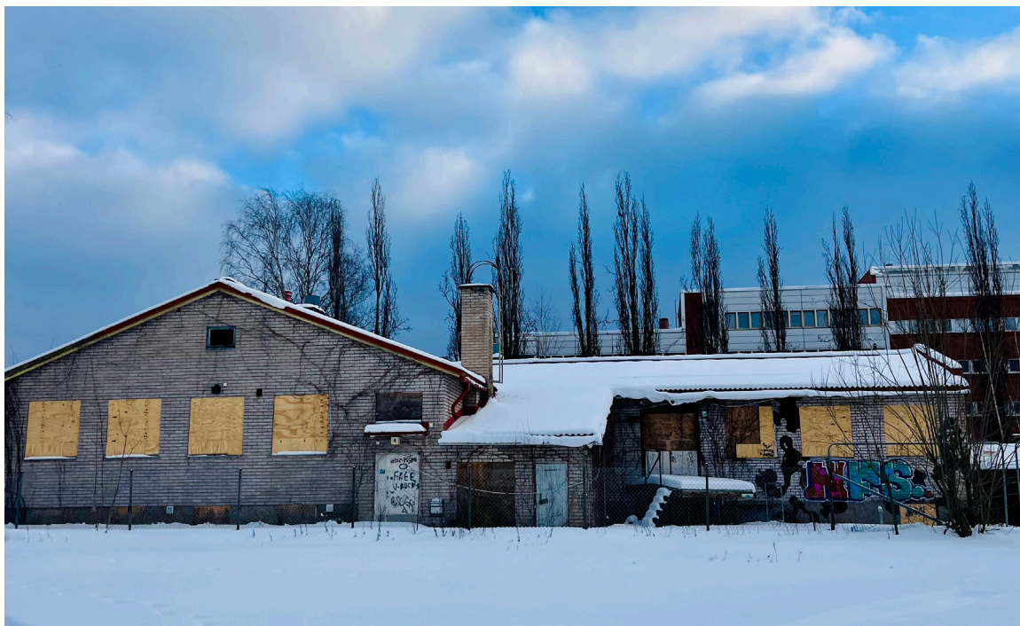
Suojellun rakennuksen ullakkoikkuna on avoinna. Omistaja lupaa tilkitä sen.
