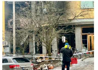
Liiketila paloi lohdukkomaan kuntoon. Myös toisen kerroksen huoneisto kärsi vaurioita.
