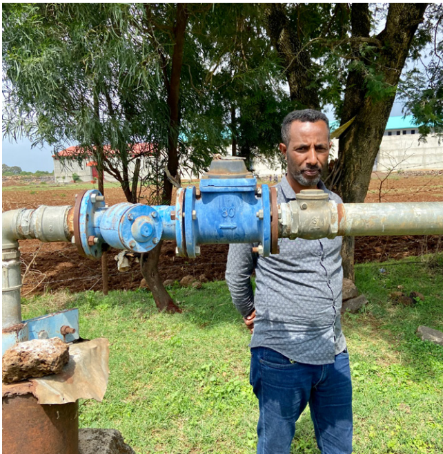
Porakaivon olemassa oleva mekaaninen mittari, joka korvataan uudella magneettisella virtausmittarilla
