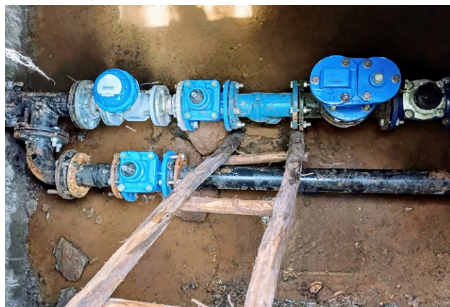
Krohen mittari ja muuta laitteistoa asennettuna mittauskaivossa
