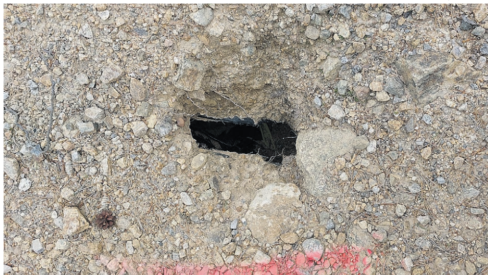
Kaapeliauralla tierunkoon asennettu kaapeli: rumpu poikki ja tiessä reikä.
