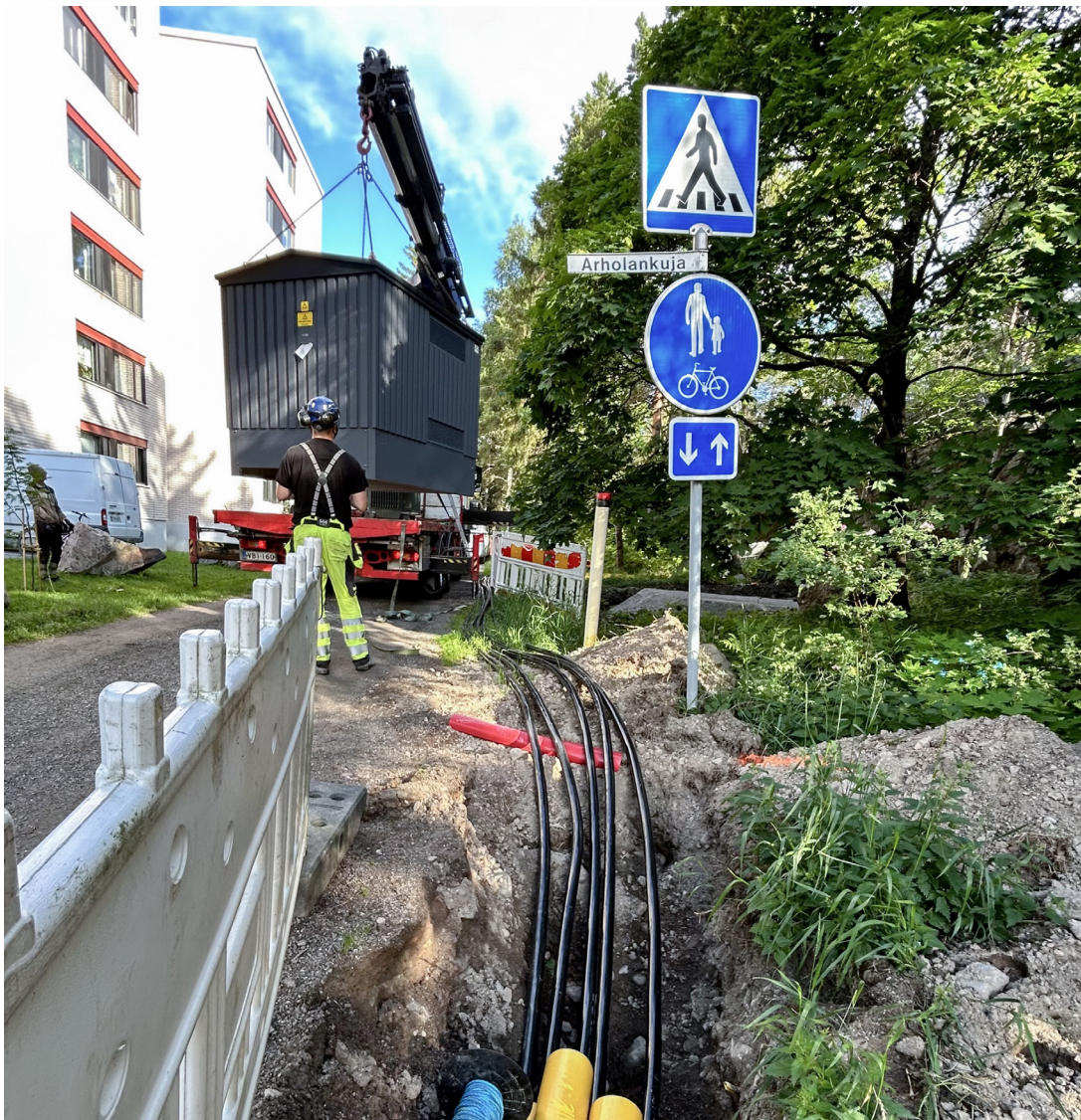
Naantalin Energia asensi kesän aikana Arholankujalle uuden puistomuuntamon. Kuva: Naantalin Energia
