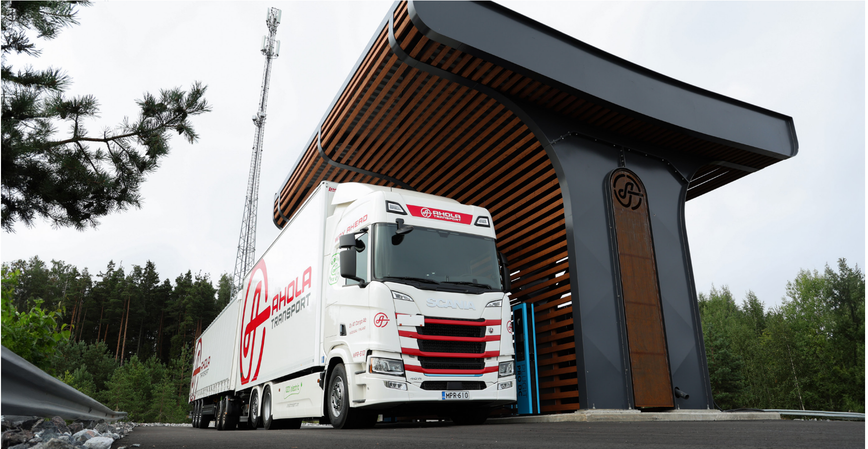
Ahola Transport on rakentanut Luolalan alueelle Naantaliin järeätehoisen, kaikille avoimen latauspisteen. Sitä voivat hyödyntää sekä raskas liikenne että henkilöautot. Kuva: Ahola Transport
