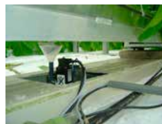
PRIVA GroScale -vaakajärjestelmä ylikastelumittauksella
