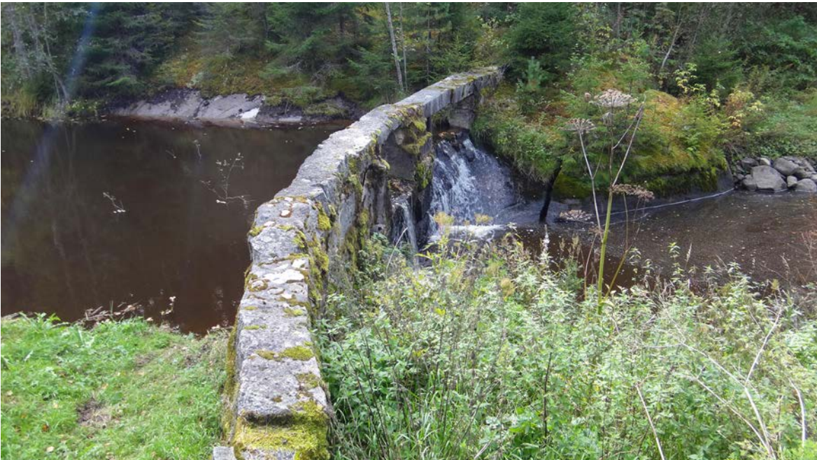
Virtavesiin rakennetuilla padoilla varastoitiin vettä ja sen tuottamaa energiaa patoaltaisiin. Vettä juoksutettiin työpäivän aikana Myllyyn tai Sahaan tarpeen mukaan. (Tampere, Kiimajoen reittiin kuuluva Ilvesjoki.)
