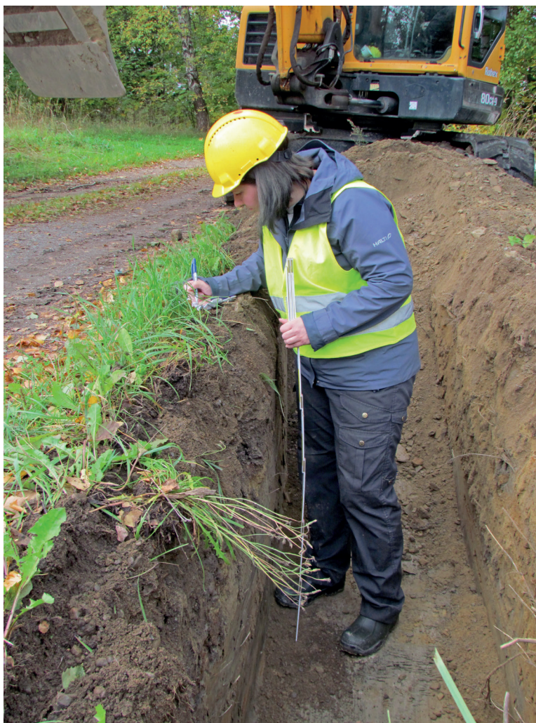
Arkeologi Mari Wuoti dokumentoi Ruokolan kartanon alueelle suunnitellulle maakaapelilinjalle kaivettua koeojaa. Kuva: Kirsi Luoto/ Kulttuuriympäristöpalvelut Heiskanen & Luoto Oy.
